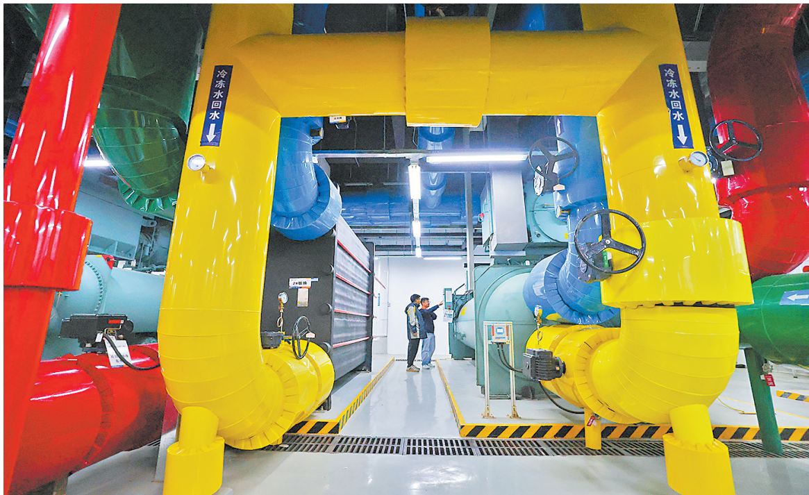
位于天津产业新城高村数智创新园的中国电信京津冀算力中心，运维工程师对冷冻站进行人工巡检。新华社记者 孙凡越 摄
