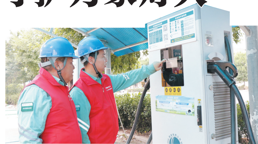
磁县供电公司党员服务队队员在《北京港澳高速冀南新区出口处检查充电桩运行状态。
