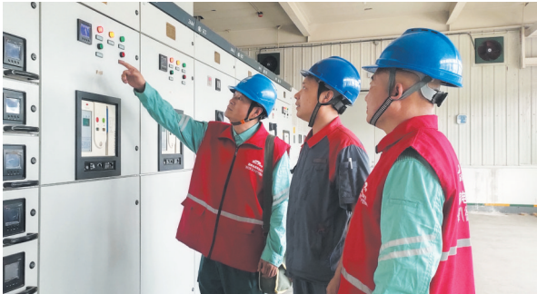
8月26日,徐水供电公司党员服务队走进风电高新电源分公司厂区,开展用电设备专项安全检查,全面排查设备风险,为企业旺季生产筑牢供电安全屏障。 史超 罗端 摄
