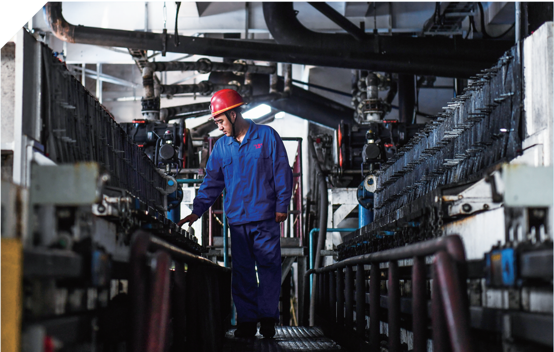
今年以来,开滦股份林西矿业公司以设备管理为重点,合理制定设备检修计划,围绕洗煤设备进行隐患排查,全力做好设备日常检查维护,确保洗煤设备安全稳定运转。图为该公司员工在检查洗煤设备。 信明帅 摄
