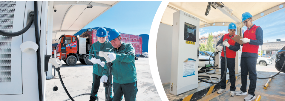
承德供电公司营子区供电中心工作人员在承德市鹰手营子矿区营子镇南环路鸿诚日升重卡充电站开展安全用电检查。李彬 摄
