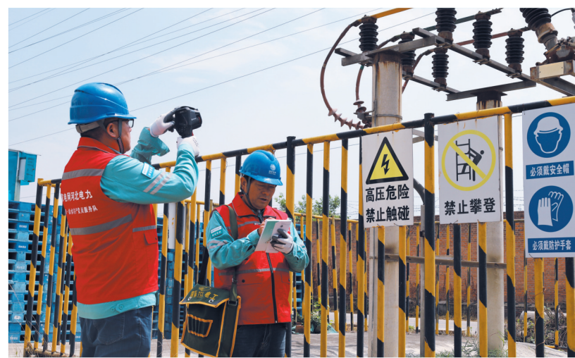
徐水供电公司紧盯迎峰度夏关键时段,常态化开展重点企业、重要场所用电安全检查,加强电网设备日常运维与负荷监测,不断提升供电保障与优质服务水平。图为7月23日,徐水供电公司党员服务队走进徐水高新电源公司开展迎峰度夏专项用电安全检查,助力企业平稳应对夏季用电高峰。 史超 罗瑞 摄
