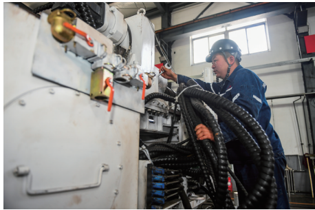
今年以来，开滦集团唐山矿业公司坚持以机保产，为每台设备划定包机责任人，严格落实包检查、包检修、包设备完好“三包”要求，依据设备检修结果兑现奖励，促进包机人员履职尽责，提升机电设备管理水平。图为该公司检修人员在对检修完成的设备进行核验。 崔奕 郝壮 摄
