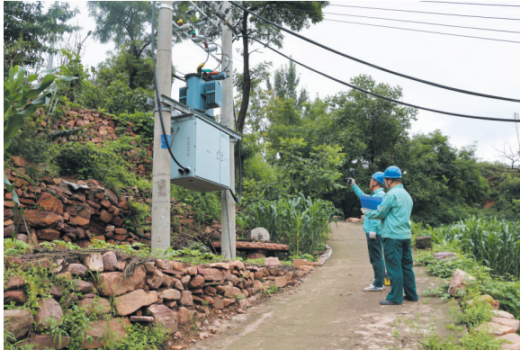
进入汛期以来,武安供电公司组织人员利用无人机、红外测温仪和局放设备等对配电线路、变压器、开关柜等核心电力设备开展“拉网式”巡视排查,及时消除安全隐患,为设备健康运行打下坚实基础。 陈四海 摄
