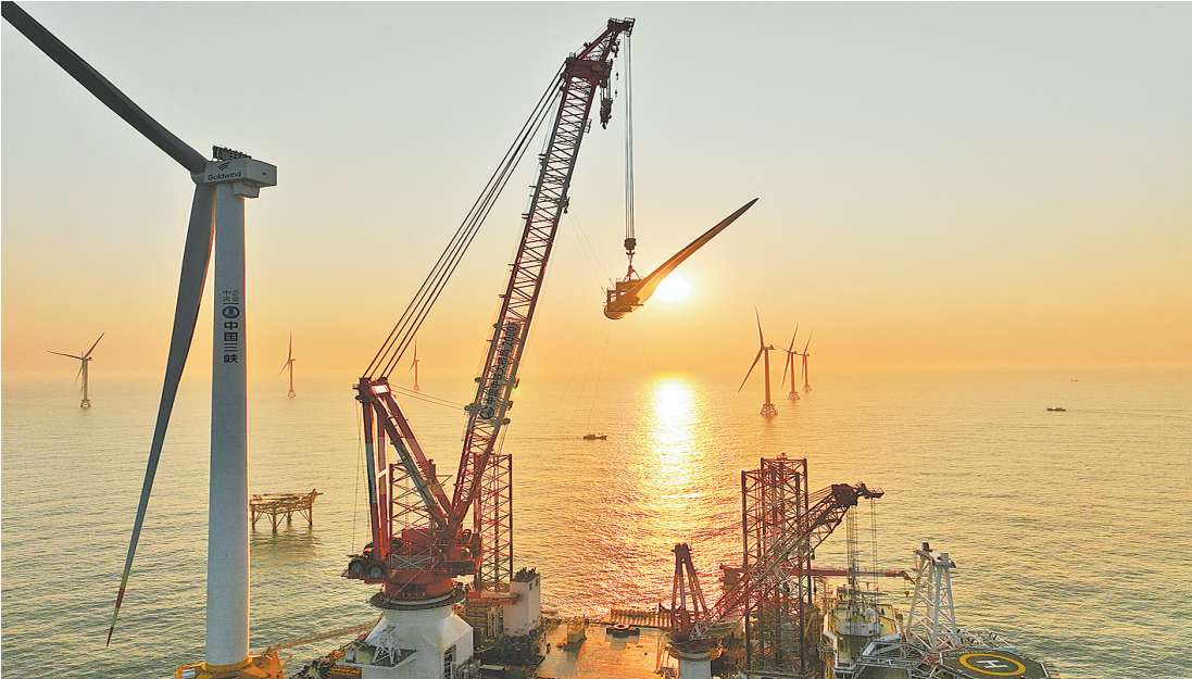
在三峡集团福建漳浦六鳌海上风电场拍摄的二十兆瓦海上风电机组和『大桥海风』号两千吨自升式海上风电安装平台。
