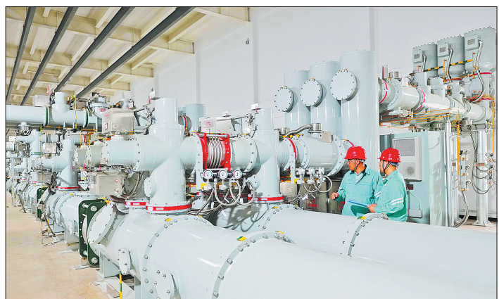
近日,位于武安市境内的500千伏超高压邯郸北输变电工程竣工投运。该工程由一座500千伏超高压变电站和配套线路组成,是河北南部电网电力发展规划重点项目和河北电网东西电力互济的核心枢纽工程,投运后将依托连晋、鲁两地的跨区域东西电力互济通道,为冀南地区推动传统产业绿色转型提供可靠能源保障。图为6月29日,工人在巡检(无人机照片)。
