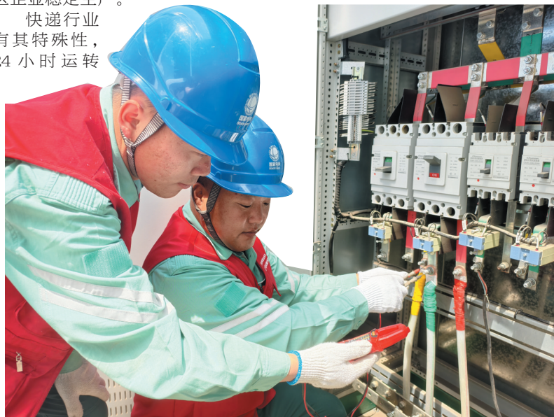
双滦区供电中心工作人员在承德快递产业园检查低压配电箱,保障园区供电。孙婷婷 摄
