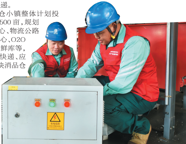
双滦区供电中心工作人员在承德快递产业园内检查用电设备,确保安全稳定运行。孙婷婷 摄
