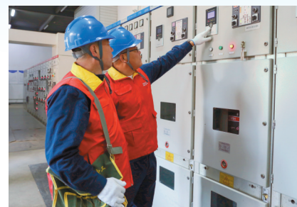
国网廊坊供电公司员工帮助企业检查电气设备。王少坤 摄
