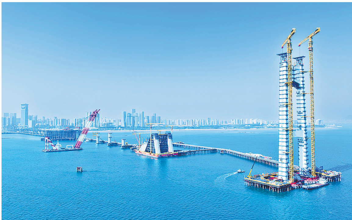
建设中的厦金大桥(厦门段)项目工标段全景(无人机照片)。新华社记者魏培全摄。
