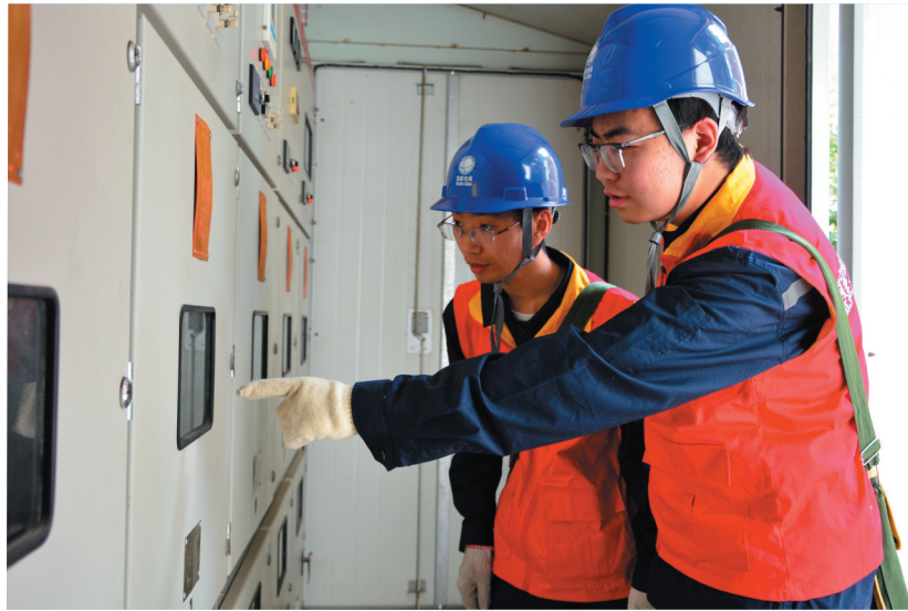
为抓实高考考点供电保障，营造安全、平稳、可靠的应试用电环境，6月4日，国网三河市供电公司党员服务队深入辖区各高考考点，提前开展用电隐患专项排查，以电力担当守护万千考生圆梦之路。图为该公司运维人员到三河市第一中学，在高考前为学校检查用电设备和巡视线路。（王占武 摄）
