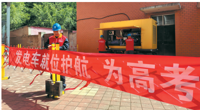
6月4日，在承德市双滦区承德实验中学高考保电现场，承德供电公司双滦区供电中心工作人员正在接入发电车，全力保障高考期间用电安全。（孙婷婷 摄）
