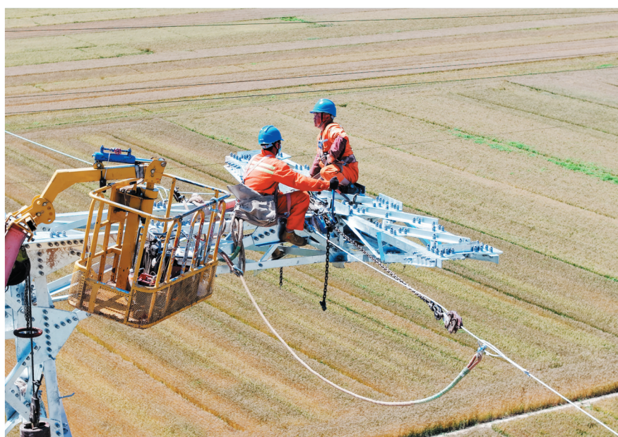
5月31日2时58分,平乡城东(田付村)110千伏变电站2台主变压器顺利完成五次冲击合闸,标志着国网邢台供电公司平乡城东(田付村)110千伏输变电工程正式竣工投产。
