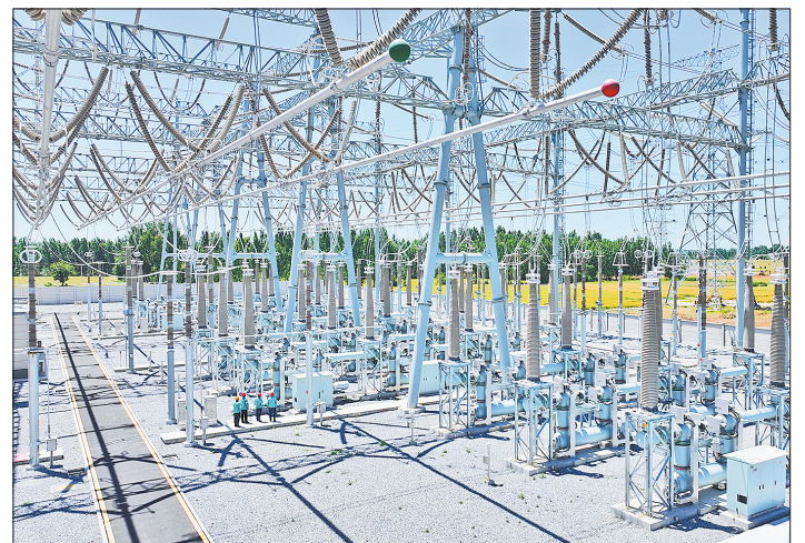
6月2日,工人在位于涿州市境内的国网涿州500千伏超高压变电站巡检(无人照照片)。
