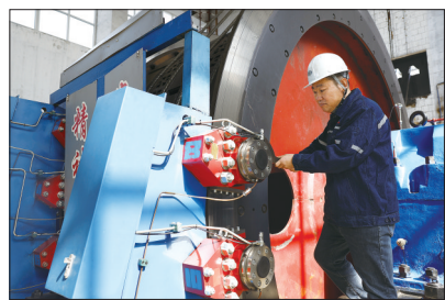
开滦集团唐山矿业公司持续强化机电隐患排查工作,每周对变电站、主要泵房等关键场所和重点部位开展“过筛子”式安全隐患排查,重点检查设备运行状态、保护装置可靠性等方面,确保不留死角、不留盲区。图为该公司机电检修人员在检查提升设备。 崔奕 郝壮 摄
