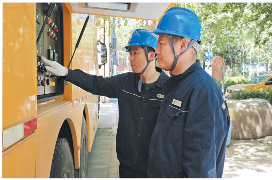
为扎实做好6月份高考电力保障工作，提前检验应急供电处置能力，5月7日，国网三河市供电公司依托三河一中校园实景，组织开展高考保电专项应急演练拉练，以实战练兵方式，全面锤炼保电队伍应急响应、故障处置及备用电源投运能力。王占武 摄
