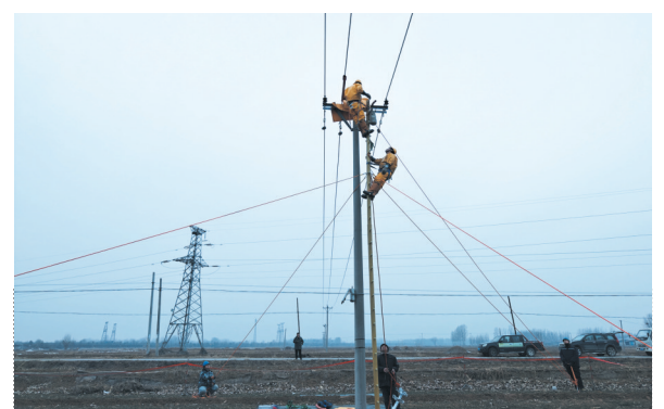
4月13日,涿州供电公司组织运维人员赶赴松林店供电所辖区,对南岐515线路西古邱村东地分支001号杆开展应急抢修作业,及时处置中相导线脱落隐患,全力保障居民及企业用电安全稳定。余果 摄
