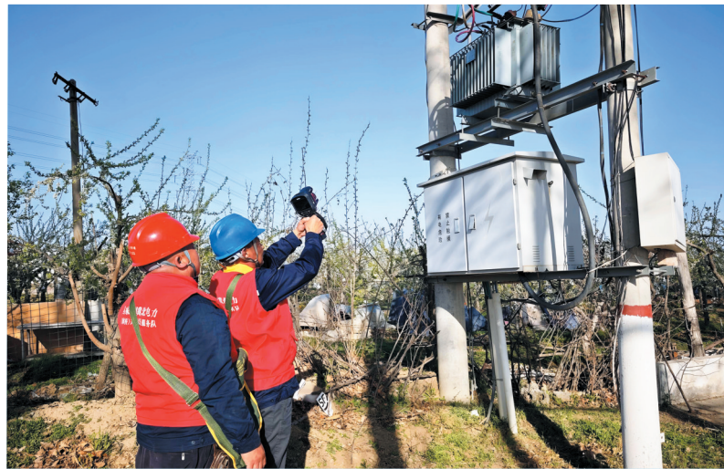
4月10日，国网三河市供电公司共产党员服务队走进燕郊大石梨园种植基地，开展专项电力巡检，全力保障梨花观赏期间用电安全可靠，以可靠电力守护春日“花经济”。 王占武 摄
