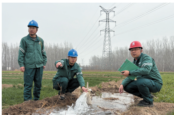
近日,为保障农排线路安全稳定运行,阜城供电公司组织运维人员深入开展农排线路及春灌用电设施专项巡视检查,确保农户春灌用电无忧。 王迪 摄
