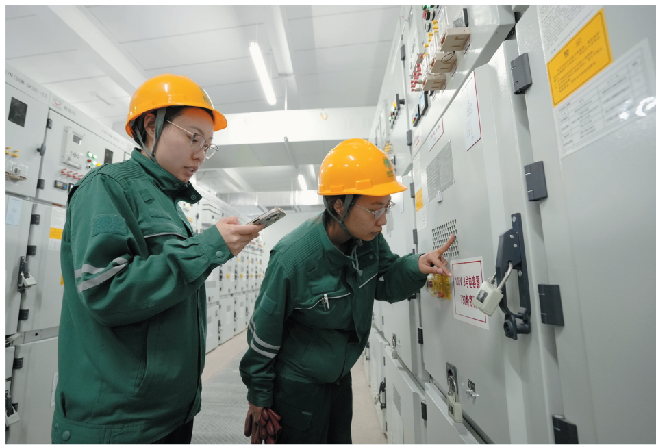
3月31日,随着主变五次冲击试验顺利完成,国网石家庄供电公司文盛(北京)110千伏变电站正式投运。该项目的实施将进一步优化区域电网网架结构,有效缓解220千伏韩通变电站供电压力,为石家庄生物医药产业集群高质量发展筑牢电力根基。 武婕 耿一朝 王静 摄
