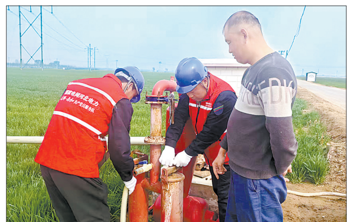
3月27日,国网邢台市南和区供电公司东薛屯供电所员工到南和区金沙河小麦标准化种植基地排查农业排灌用电设备,了解春灌用电需求,助力农民开展春季田间管理工作。王培 刘博 摄
