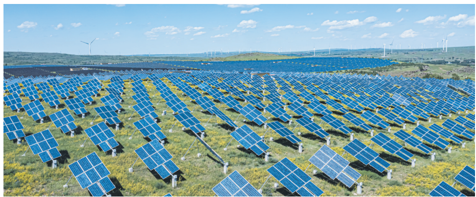
国家风光储输示范工程光伏电站实验区。梁立新 摄
