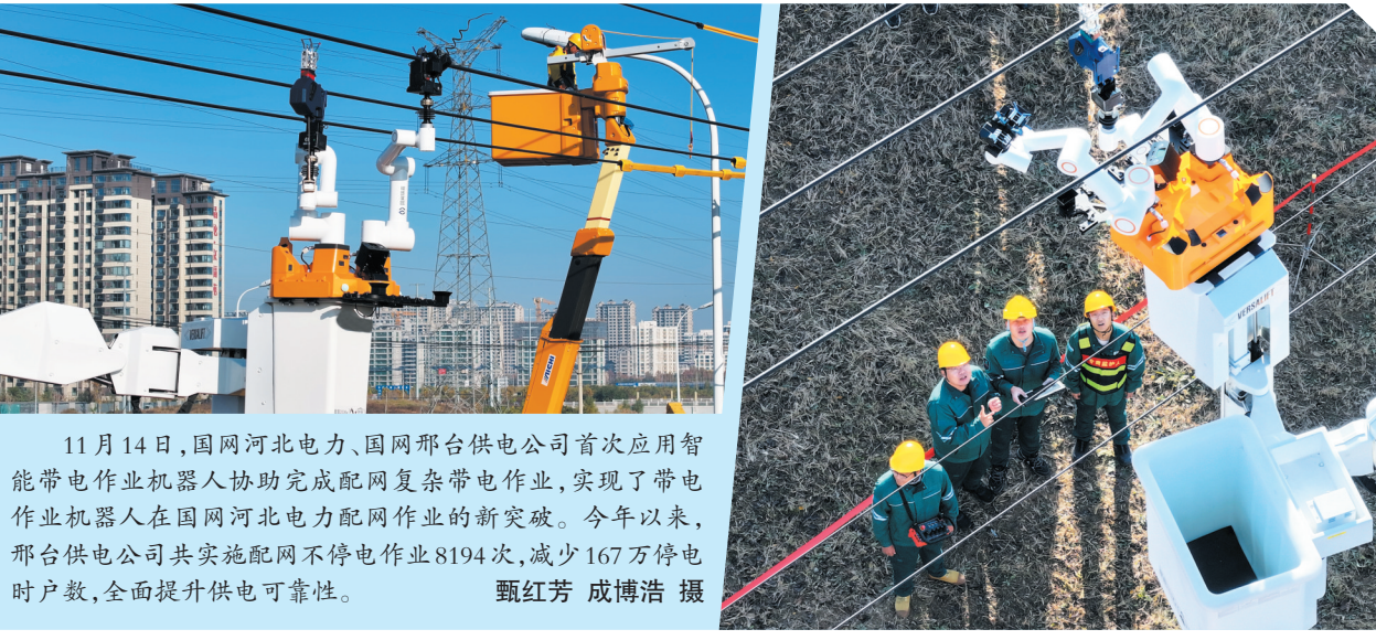
11月14日,国网河北电力、国网邢台供电公司首次应用智能带电作业机器人协助完成配网复杂带电作业,实现了带电作业机器人在国网河北电力配网作业的新突破。今年以来,邢台供电公司共实施配网不停电作业8194次,减少167万停电时户数,全面提升供电可靠性。甄钰芳 成博浩 摄
