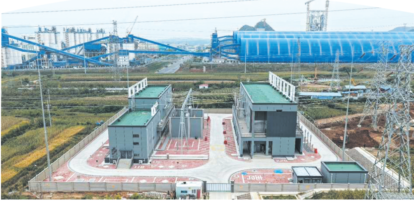
邯郸供电公司青龙220千伏输变电工程全貌。 张晓琪 摄
