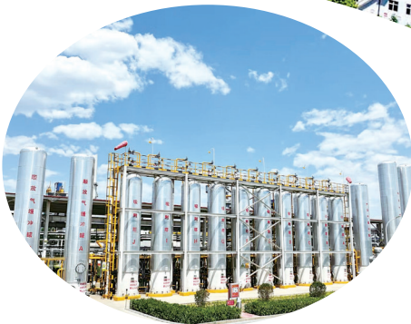
旭阳集团定州园区氢能生产装置。
