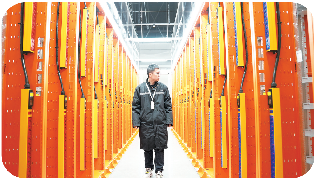
张北县云联数据中心运维人员进行巡检。
