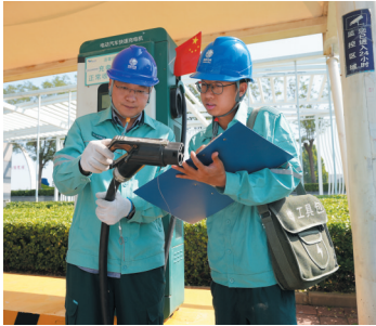
为积极应对国庆、中秋假期出行高峰,冀州供电公司充电桩开展全面巡视排查,对查出的隐患进行登记并及时消除,确保充电设施安全可靠运行。 邵印 摄
