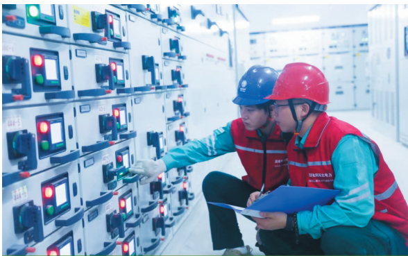
9月10日,涿州市供电公司党员服务队走进国家分子育种创新中心,对园区配电室及重点设备开展用电检查,为推动农业科技园区加快建设、成果加速转化提供电力支撑。余果 摄
