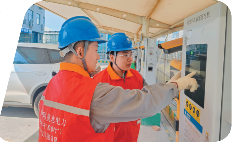
乐亭供电公司员工在电动汽车充电站检查充电桩运行情况 赵倩 摄
