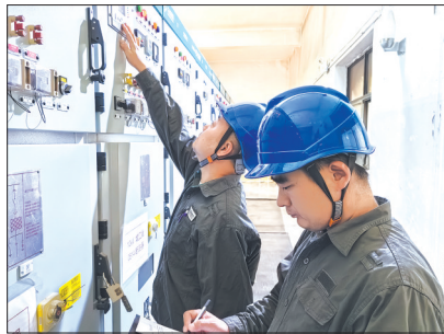
日前,国网沙河市供电公司员工对35千伏城南站设备进行巡视检查,保障迎峰度夏期间电网设备安全稳定运行。 通讯员 彭晓伟 郝丽梅 摄
