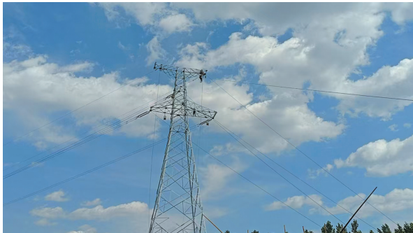
6月30日,220千伏威基站宗成I线273开关顺利投运,标志着邢台供电公司220千伏宗州—威基输电工程正式投运,为度夏期间电力可靠供应奠定了坚实基础。 崔延平 陈秦超 李征 成博浩 摄
