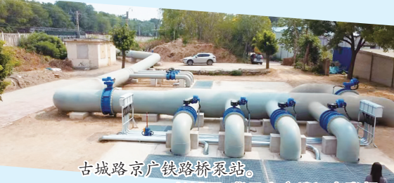
古城路京广铁路桥泵站。 长城网·冀云客户端记者张超
