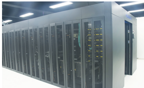
数据中心机房。
