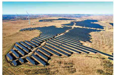
张家口高速公路发展有限公司尚义县20万千瓦光伏项目二十号地块光伏板安装工作已圆满完成，标志着该项目取得了突破性进展。 柳阳 摄
