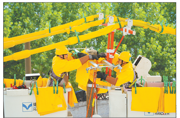
为确保迎峰度夏可靠供电，国网邢台供电公司全面推广配网不停电作业，确保抢修处理客户“零感知”。近日，该公司开展带电作业技能竞赛，推动员工苦练本领，保障供电。 成博浩 摄
