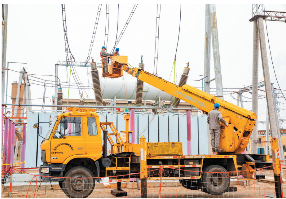
今年以来,秦皇岛供电公司结合春检预试,对变电站、配电室、输电线路存在的缺陷和隐患进行及时消除,确保电网安全稳定运行,为当地经济社会发展提供可靠电力保障。图为5月23日秦皇岛供电公司员工在220千伏五里台变电站处理4号主变将军帽过热缺陷,提升设备健康水平。史文全 摄
