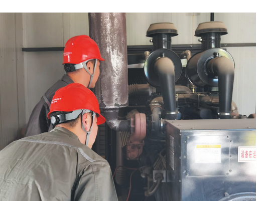
万全供电公司工作人员对万全中学备用发电机进行检查。王帅 摄
