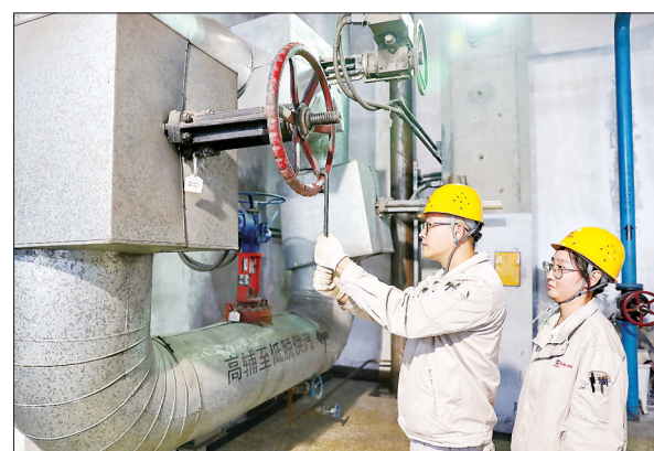
随着供暖期临近,秦皇岛秦热发电有限责任公司组织工作人员对燃煤供热发电机组各项设备回装、验收、传动等抓紧检修和日常巡检,待完成后启动并网,为城市集中供热和电力稳定提供有力保障。曹建雄 摄
