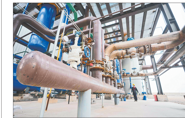
10月19日,沧州临港金诚化工有限责任公司工作人员对氢气供应管网进行日常巡检。近年来,沧州渤海新区黄骅市临港经济技术开发区坚持“生态优先、绿色发展”理念,打造多条各具特色的循环经济产业链,降低安全生产风险,减少污染物排放和能源消耗,压缩企业建设和运营成本,实现经济效益、社会效益和环境效益共赢。
