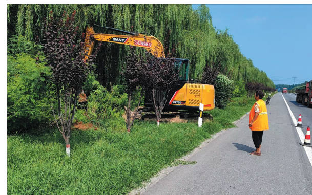
近期，强降雨对临漳县境内农村公路部分路段造成不同程度损毁，临漳县交通运输局迅速开展创修工作，全力保障道路安全畅通。
