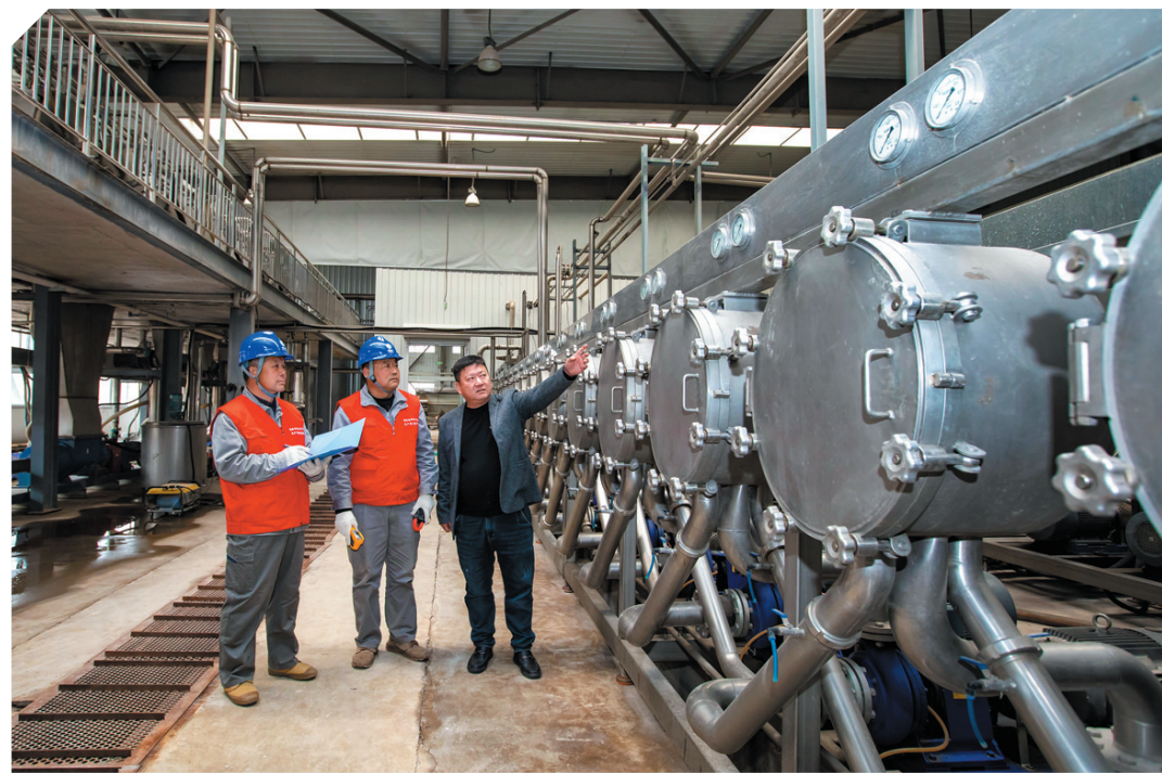
3月23日,秦皇岛供电公司陈官屯供电所党员服务队到河北中薯农业科技集团股份有限公司开展用电服务,向客户了解用电需求,帮助检查设备用电安全,排查消除安全隐患,保障企业生产安全可靠用电。 史文全 摄
