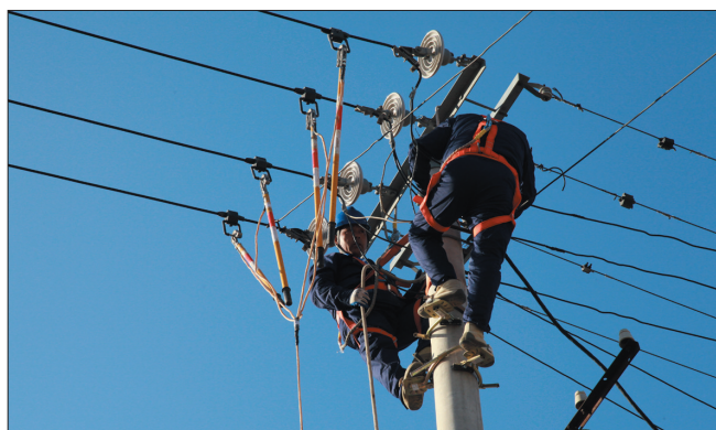
为做好春检工作,高阳县供电公司从多方面入手,细化保障措施,开展春季安全隐患大排查,有效提高供电可靠性。 王浩洋 摄
