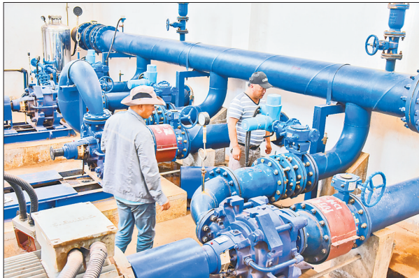
3月2日,工作人员在喀麦隆西部大区的巴富萨姆饮用水处理厂检查送水泵房。2014年,中地海外集团喀麦隆公司通过九城市供水项目一期工程,为喀4个城市建设饮用水处理厂及相关配套设施。2017年,新水厂的建设使原水厂供水能力提升了30%,总共覆盖约50万居民,覆盖率达到约65%,不仅增强了巴富萨姆的供水能力,更辐射了周边6个城镇。新华社发(科普索 摄)
