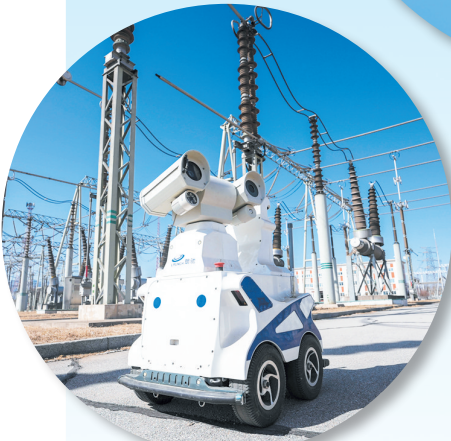
▲3月6日,国网冀北超高压公司在500千伏变电站内运用智能巡检机器人开展供电保障工作。王富强 摄
