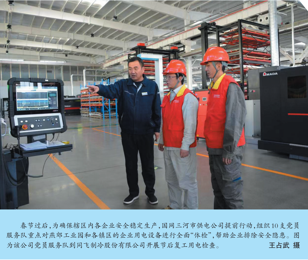
春节过后,为确保辖区内各企业安全稳定生产,国网三河市供电公司提前行动,组织10支党员服务队重点对燕郊工业园和各镇区的企业用电设备进行全面“体检”,帮助企业排除安全隐患。图为该公司党员服务队到同飞制冷股份有限公司开展节后复工用电检查。王占武 摄
