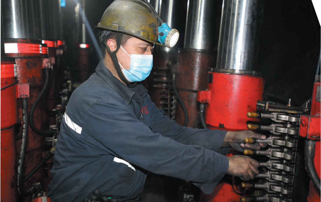
四季度以来,冀中能源峰峰集团万年矿牢固树立“安全第一,预防为主”安全理念,全方位抓好安全生产管控,做足安全功课。图为该矿职工在井下检查液压支架。
