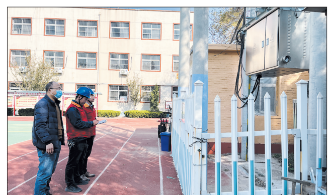
为切实做好冬季电力安全和优质服务工作,保障群众取暖可靠用电,国网景县供电公司认真学习贯彻党的二十大精神,全力做好保供保暖用电服务,让百姓温暖过冬。图为11月7日,该公司员工走进津流河中学宣传安全用电知识,对配电设施进行安全检查。罗庆超 冯钊 摄
