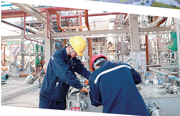
专业技术人员对生产装置进行日常维护。
