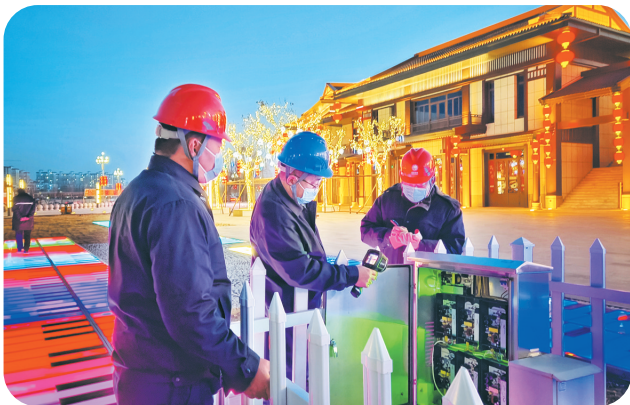
该公司提前对辖区内特高压线路、电厂送出线等关键设备进行全面巡视。 陶然 摄
