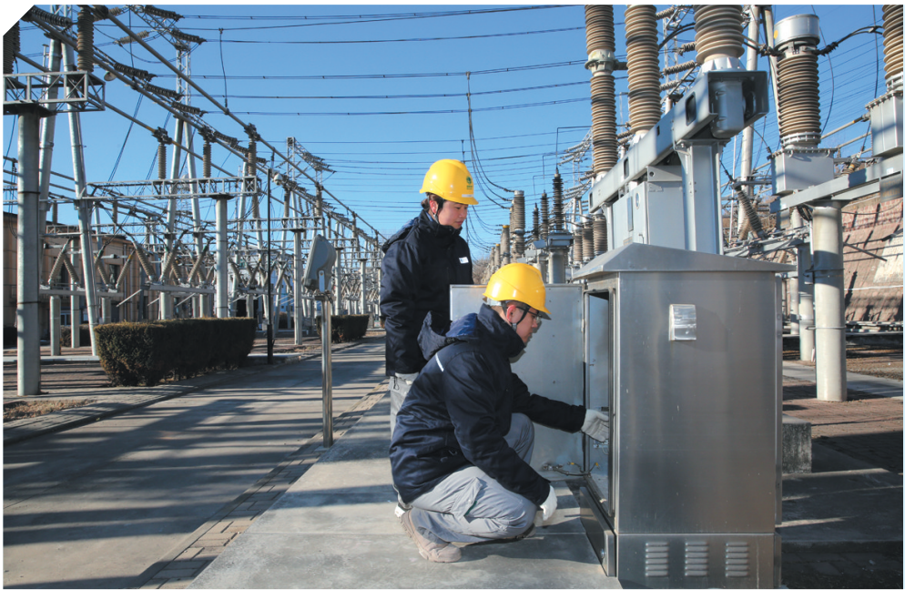
近期寒潮来袭,面对大风降温天气,冀北承德供电公司结合冬季输电设备运维特点,加强重要输电及电缆通道的清理维护,落实防范雨雪冰冻等冬季灾害的反事故措施,积极构建立体巡检体系,开展无人机和人工协同巡检,提升巡检效率和效益,确保寒潮天气下设备正常运转。 孙婷婷 盖巧琳 摄
